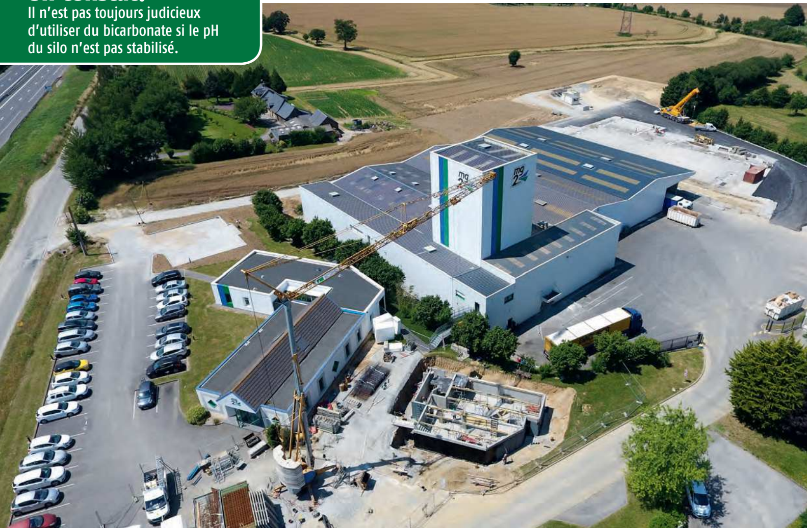
A l'usine Mg2Mix de Châteaubourg. Nouvelle ligne de fabrication blanche, extension de stockage et des bureaux. Travaux en cours.
